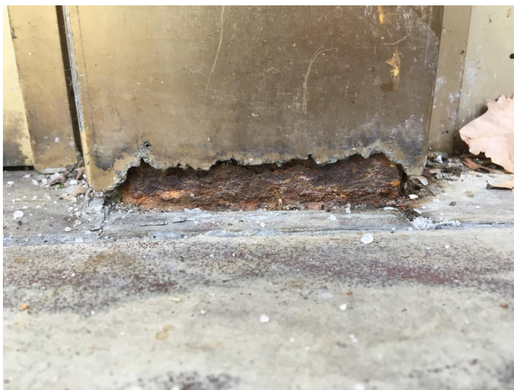
Dettagli dei diffusi fenomeni di ossidazione al piede dei montanti verticali che sorreggono le strutture del bar
